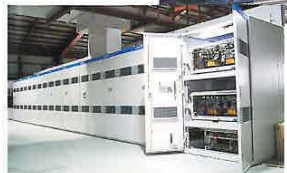
インバータ装置 Inverter equipment
